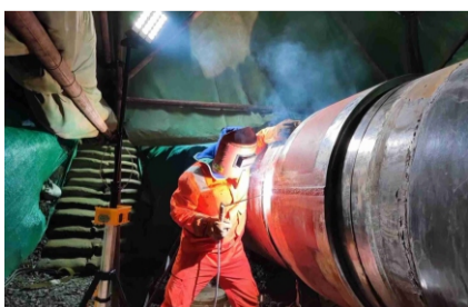
使用防爆全景移动照明系统得到客户认可
